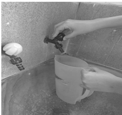
a) ABASTECIMENTO DE ÁGUA: Registro de residência com falta de abastecimento.
