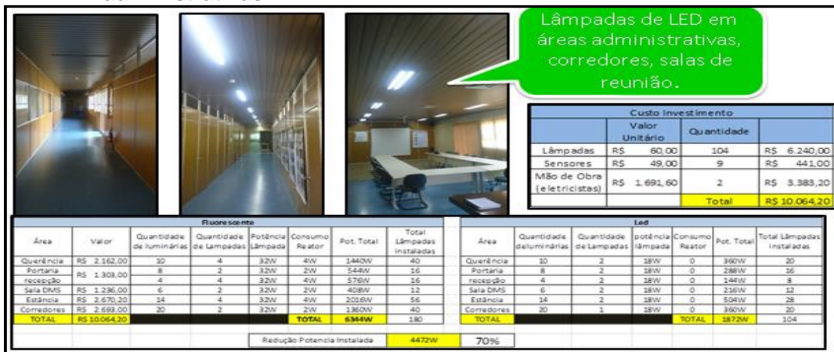
Figura 3: Instalação de iluminação de LED com sensor de presença nas áreas administrativas
