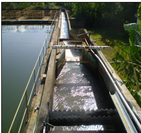
Figura 3 - Calha Parshall, Flocculador e Decantador da ETA Niterói
