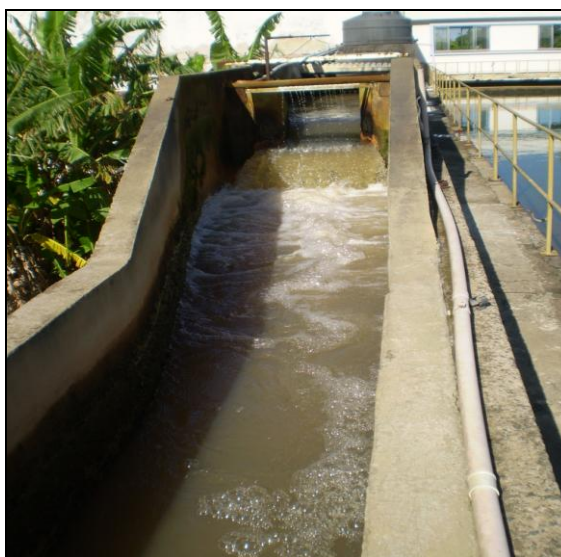
Figura 1- Calha Parshall da ETA Niterói
