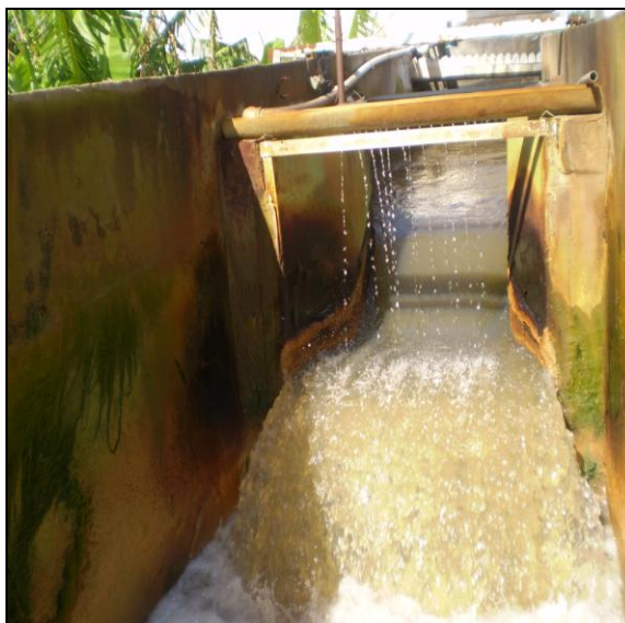
Figura 2 - Deslocamento de Massa na Calha Parshall
